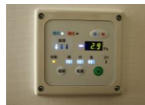
室外に設置されている操作パネル
